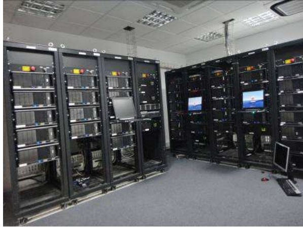
Fig. 1. Sala de equipos.
